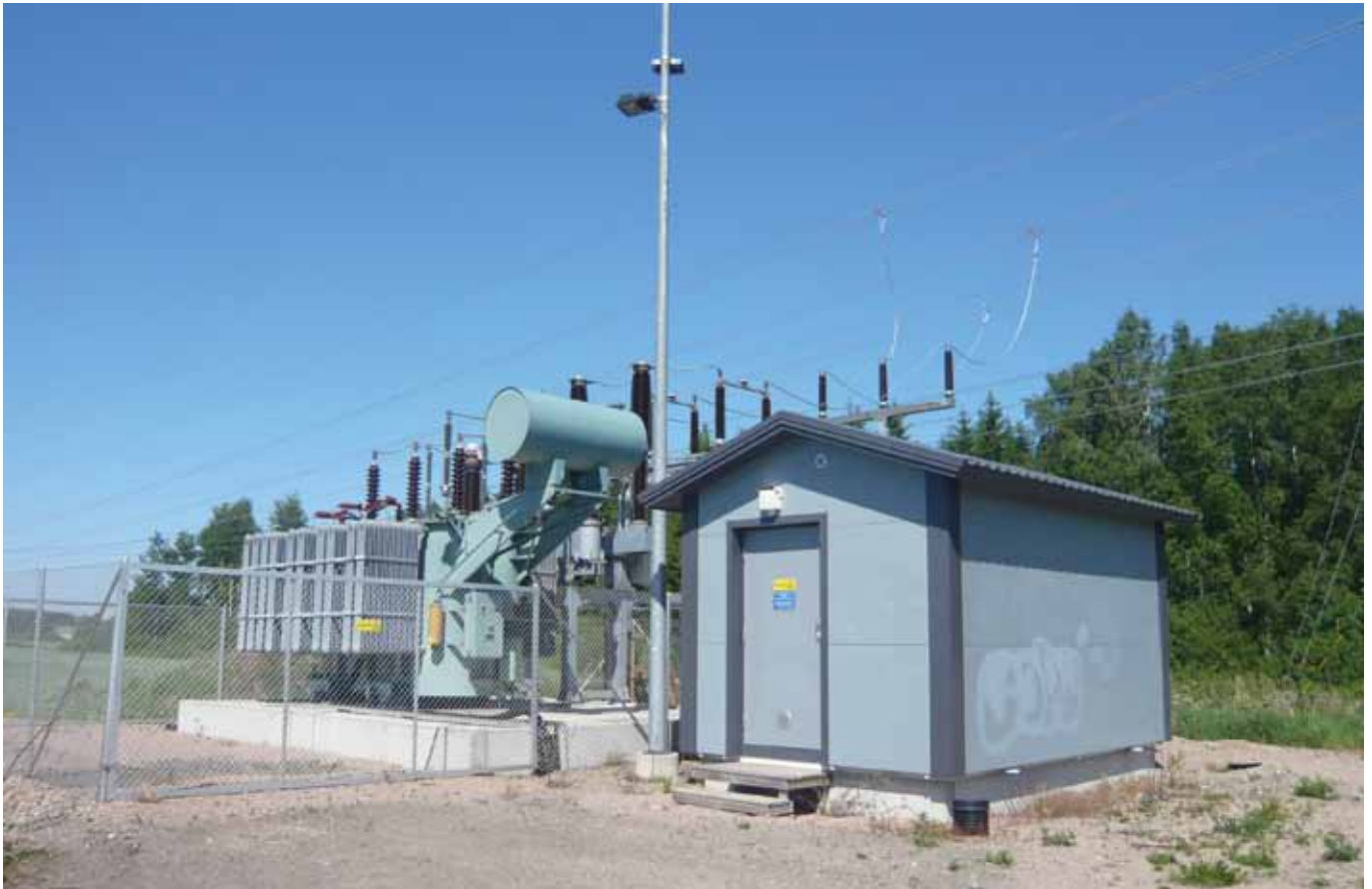
Kuva 5-5. Esimerkkikuva muuntoasemasta. (Kuva © Tiina Harpila, npd Finland Oy).
