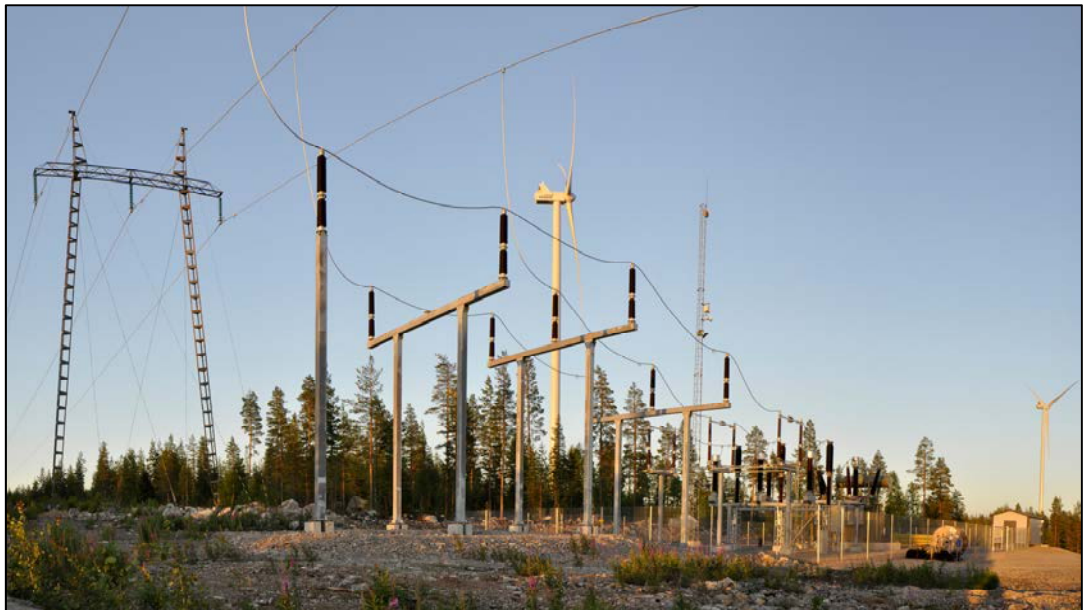
Bild 5.2. Exempelbild på 20/110 kV elstation i vindkraftsparken. (Foto: Leila Väyrynen/FCG).
